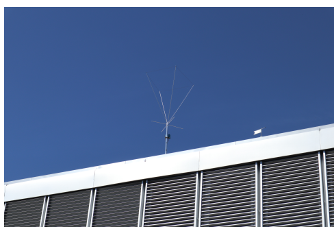
Fig. 3.8 – Antenne montée sur le toit de la halle de gymnastique. [A]
