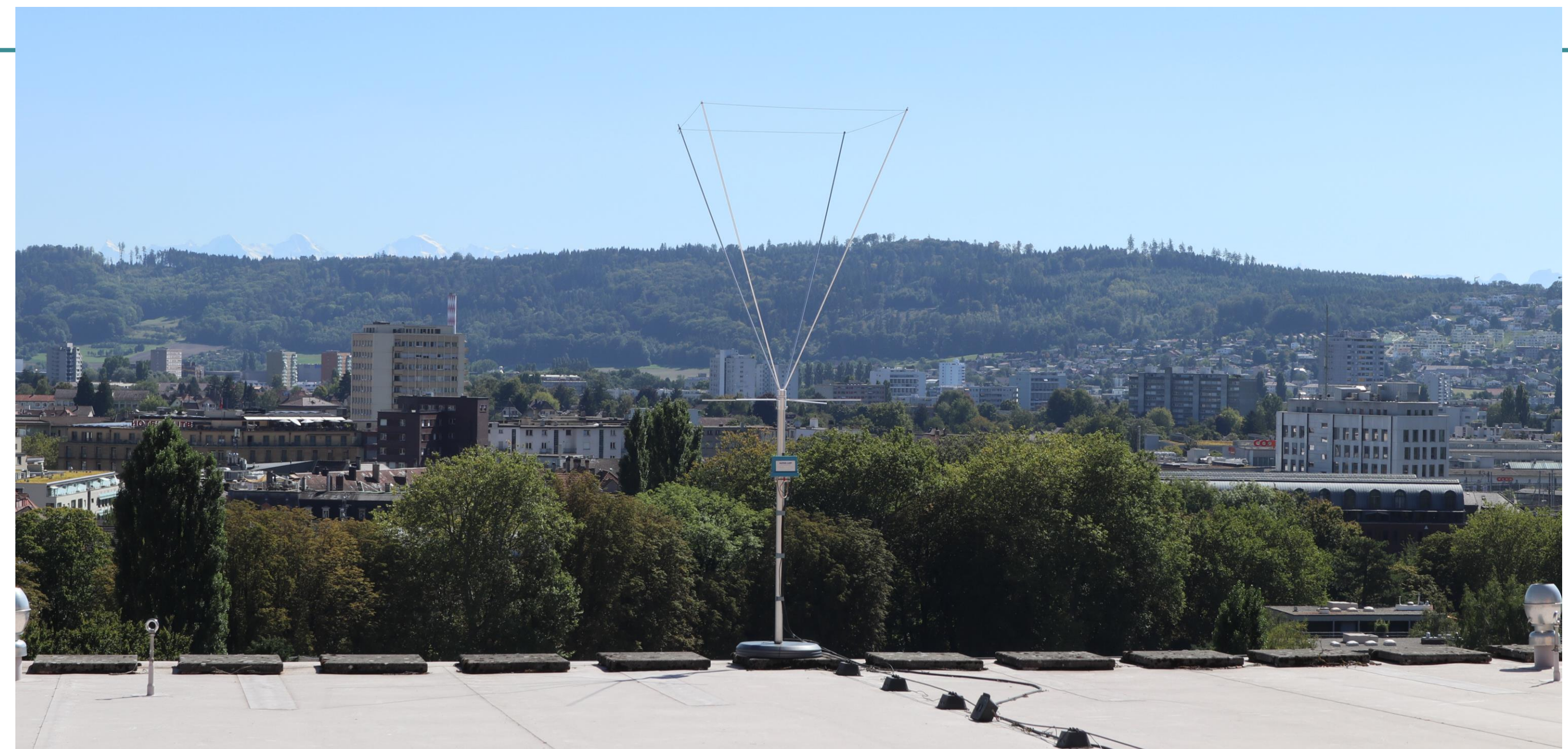
Figure 1 : Antenne réalisée sur mesure placée sur le gymnase de la rue des Alpes
