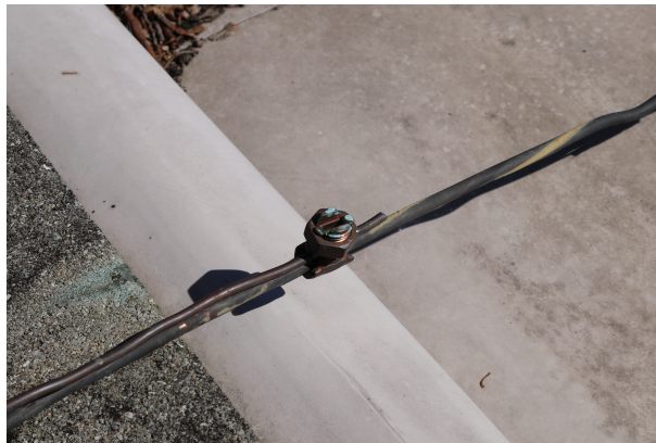
Fig. 3.10 – L'antenne est mise à la terre par raccord au paratonnerre du bâtiment pour éviter tout accident. [A]
